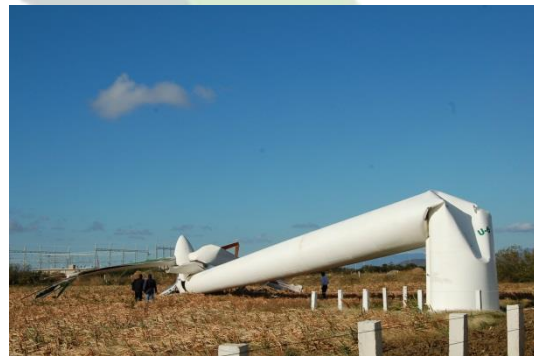
Caída del conjunto por vientos fuertes
